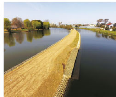
● 8041 河川改修工事（堤防修繕工） 令和元年12月 埼玉県越谷県土整備事務所表彰
